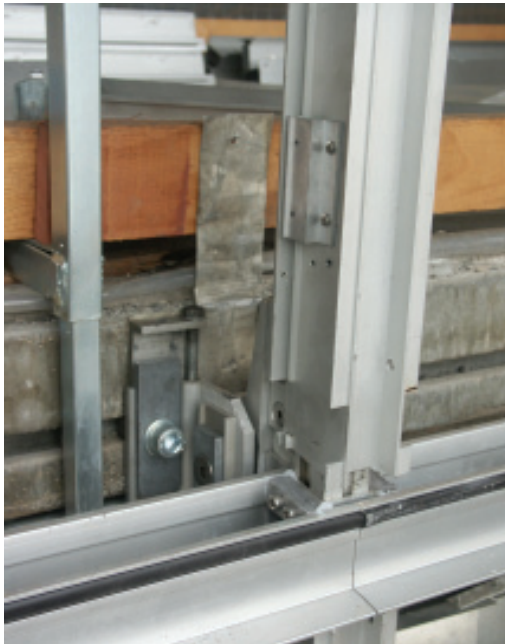
Junta de ancoragem e montantes da fachada contínua, na face exterior da laje de concreto armado, remontados depois do tratamento de reanodização e restauro Crédito: Simona Salvo
