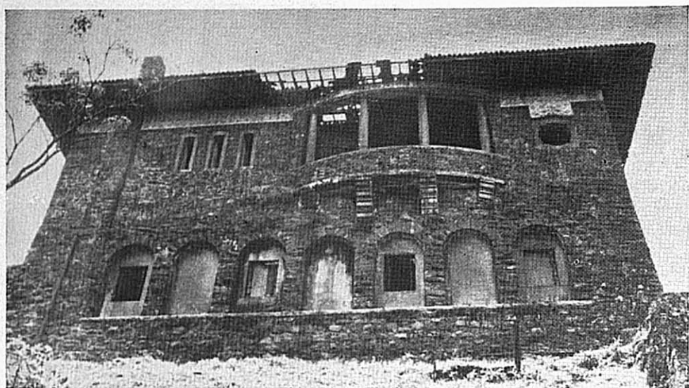
7 -- Pouso de Paranapiacaba, face voltada para a serra. Note-se o estado da cobertura e os vãos da arcada fechados com tijolos.
