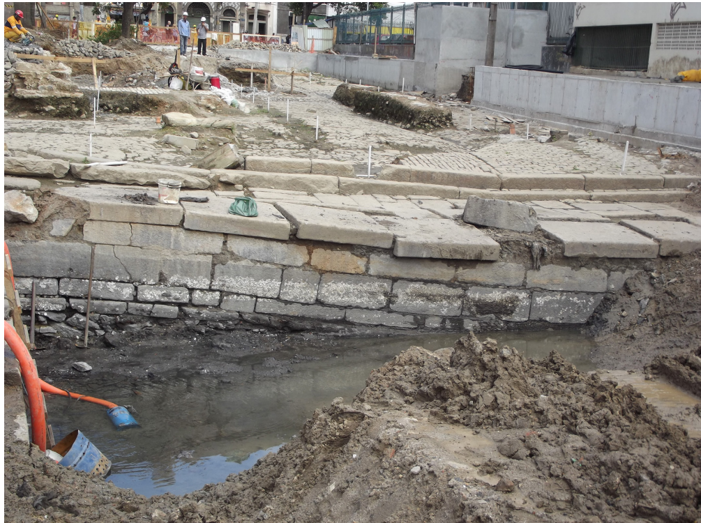
Figura 98 – O estado deplorável da estrutura do cais, já sem condições de recuperação.
