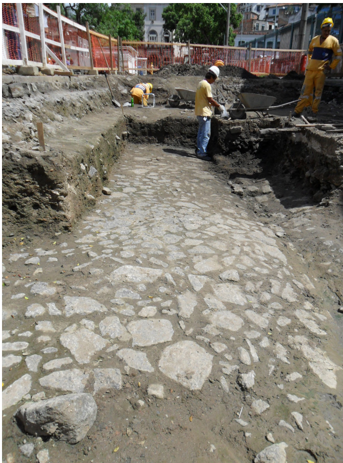
Figura 25 – Escavação em área ampla, expondo a inclinação do calçamento em direção à canaleta de escoamento de águas pluviais e em direção ao mar.
