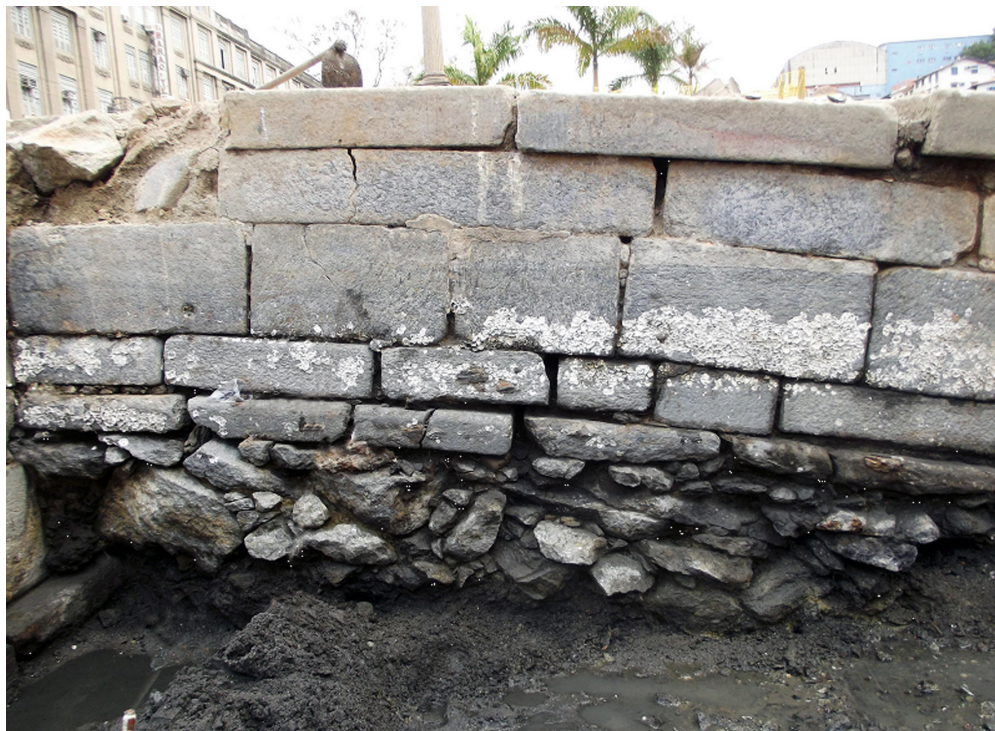
Figura 94 – Preenchimento da base da estrutura com pedras de mão para evitar seu colapso.
