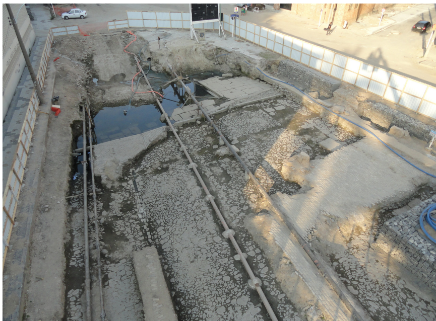
Figura 75 – A área em frente ao cais inundada, com a presença de diferentes redes impedindo a progressão das escavações. Foi preciso aguardar seu remanejamento para que a escavação pudesse prosseguir.
