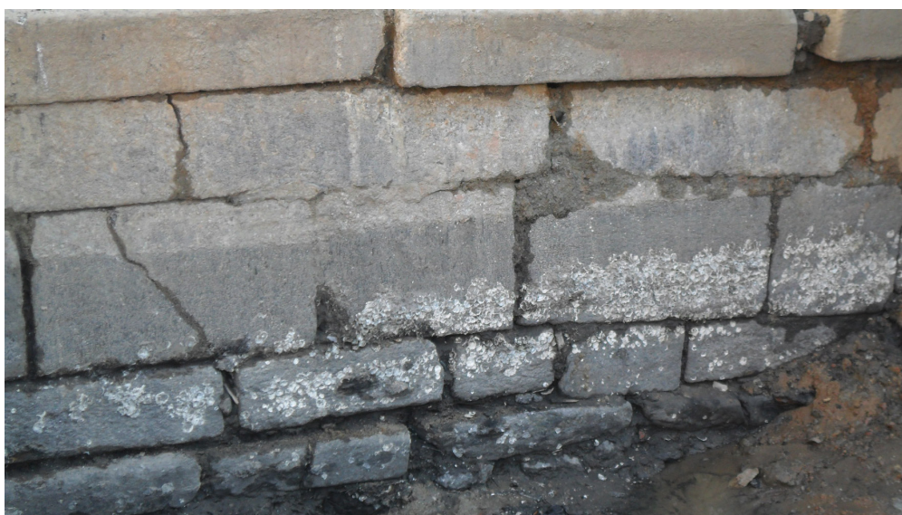
Figuras 96 e 97 – Grandes rachaduras nos blocos rochosos expõem a tensão da estrutura à época, ameaçada de colapso.
