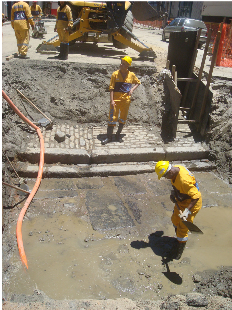
Figura 19 – O surgimento das lajotas de pedra do Cais da Imperatriz, e, acima delas, o calçamento de paralelos atribuído também a ele.
