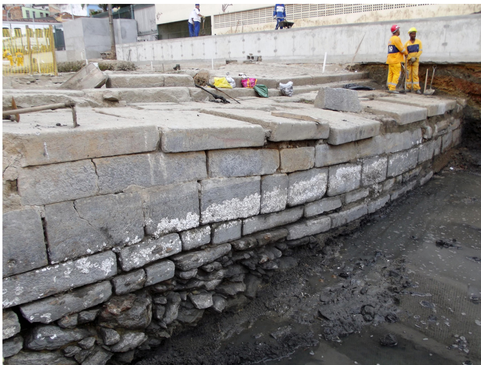
Figura 93 – As sérias avarias ocorridas na parede à direita da rampa de desembarque: afundamento da estrutura no trecho correspondente ao deságue das águas provenientes do Morro do Livramento, que solaparam suas bases; rombo na porção inferior da parede, compensado com o preenchimento com pedras de mão; e grandes rachaduras em três lajotas, expondo sua situação de absoluta precariedade. Uma seqüência de carapaças de ostreídeos aderidas às pedras e alinhadas ao longo dessa parede atesta o nível médio do mar à época. Esse paredão apresentou 2,10 m de altura, mas apenas 1,30 m no trecho em que a estrutura afundou.
