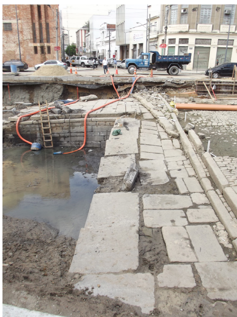
Figura 88 – Plataforma do cais com lajotas de pedra de diferentes dimensões, mas em sua maioria grandes.
