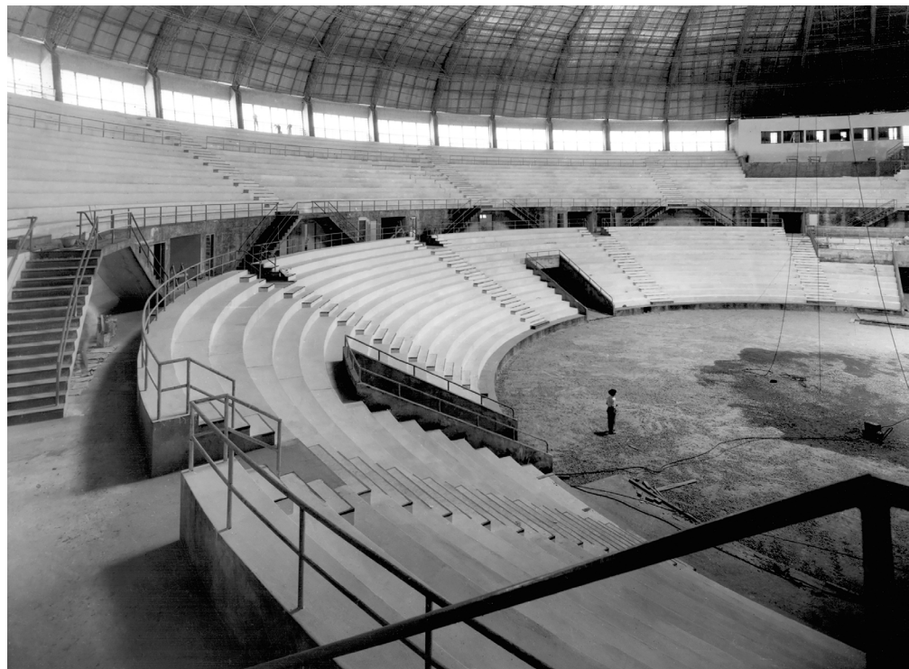
Figura 4 – Últimos trabalhos no canteiro de obras do Ginásio do Ibirapuera antes da inauguração, São Paulo, c. dez. 1956/jan. 1957. Fonte: Acervo Profissional Ícaro de Castro Mello, Faculdade de Arquitetura e Urbanismo, Universidade de São Paulo.
