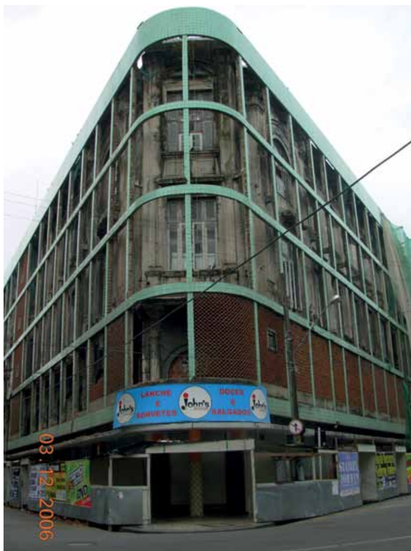
Figura 5 – Edifício Luciano Costa durante o processo de retirada dos cobogós, em 2006. Fotografia de Fátima Campello. Acervo da autora.
