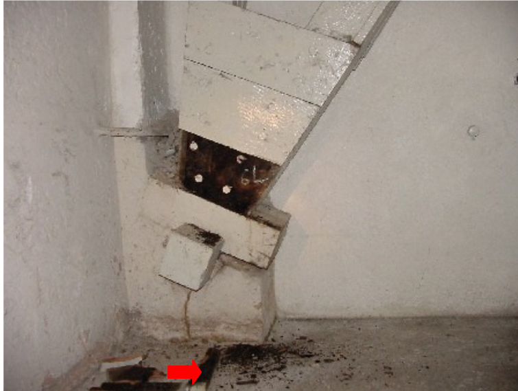
FIGURA 2 - Túnel de cupim junto a apoio de arco.
