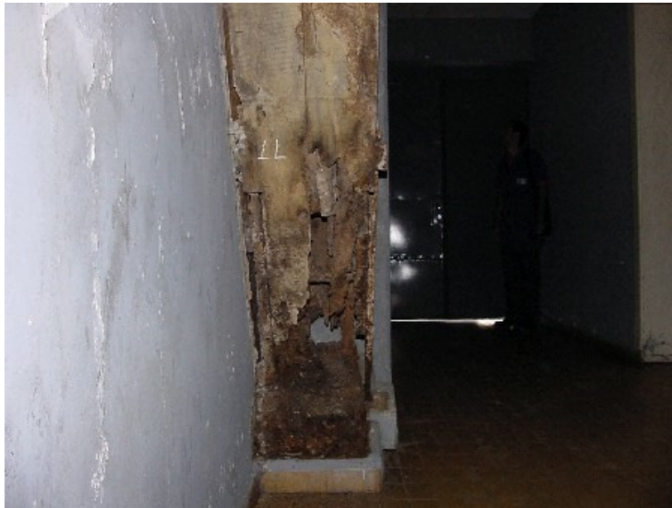
FIGURA 4 - Apoio de arco intensamente deteriorado.
