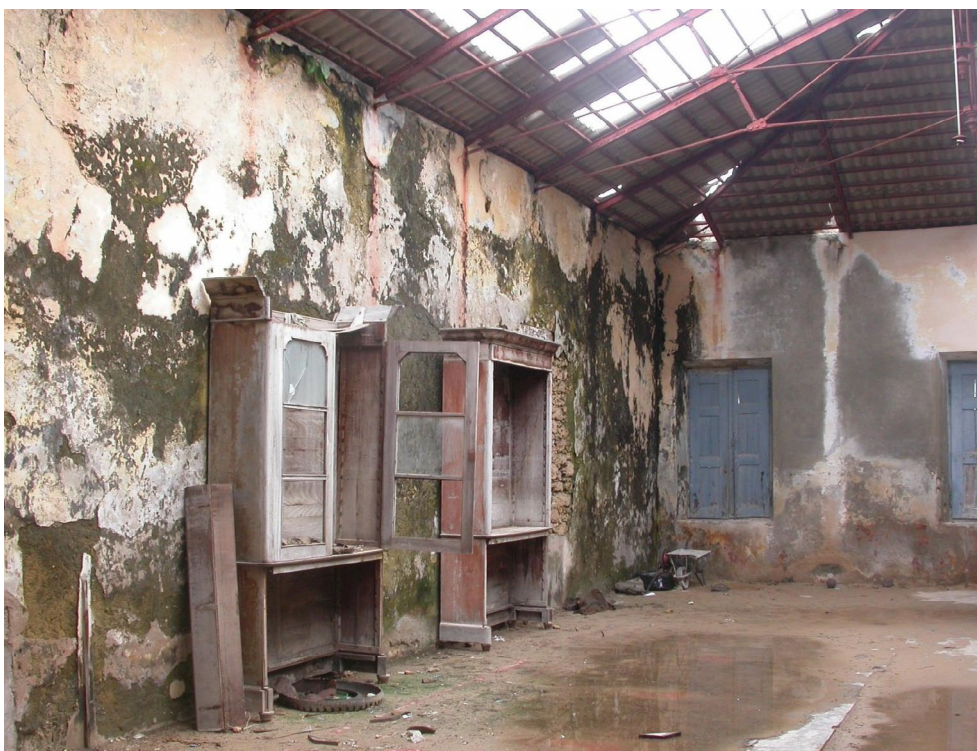
Figura 6 – Estado de degradação da maioria de casas da Cidade de Pedra e Cal. Foto: Lúcia Omar, mar. 2012
