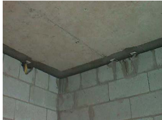
Foto 11: Interface com a tubulação
