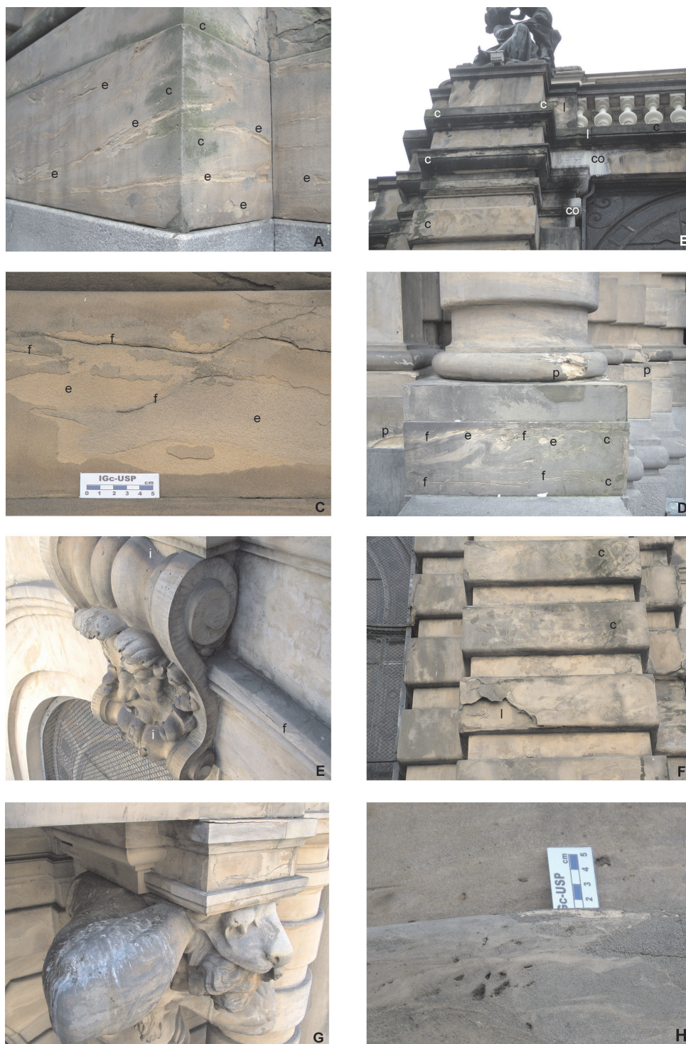
Figura 4. Formas de intemperismo observadas no Arenito Itararé na fachada frontal do Teatro Municipal. De A a F, terminologia de Henriques et al. (2005). A. Colonização biológica (c) e escamação (e). B. Concreção (co, em branco), colonização biológica e lascagem (l). C. Escamação e fissuras (f). D. Plaqueta (p), colonização biológica, fissuras e escamação. E. Incrustação (i) e fissuras. F. Lascagem e colonização biológica. G. Mancha no braço do Atlante devido às fezes de pombos. H. Presença freqüente de sulcos no arenito.
