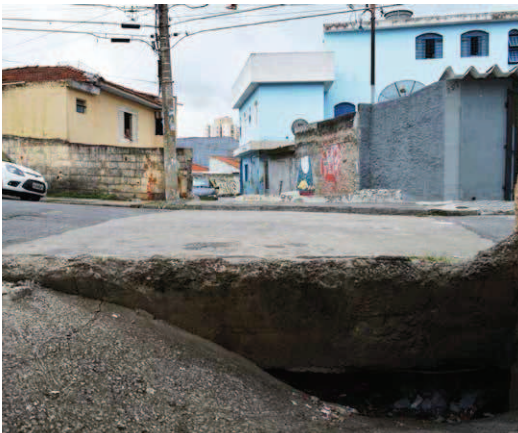
Figura 14 De ponte, a estrutura em concreto armado passou à condição de tampa. Foto: Arthur Simões Caetano Cabral – 2012
