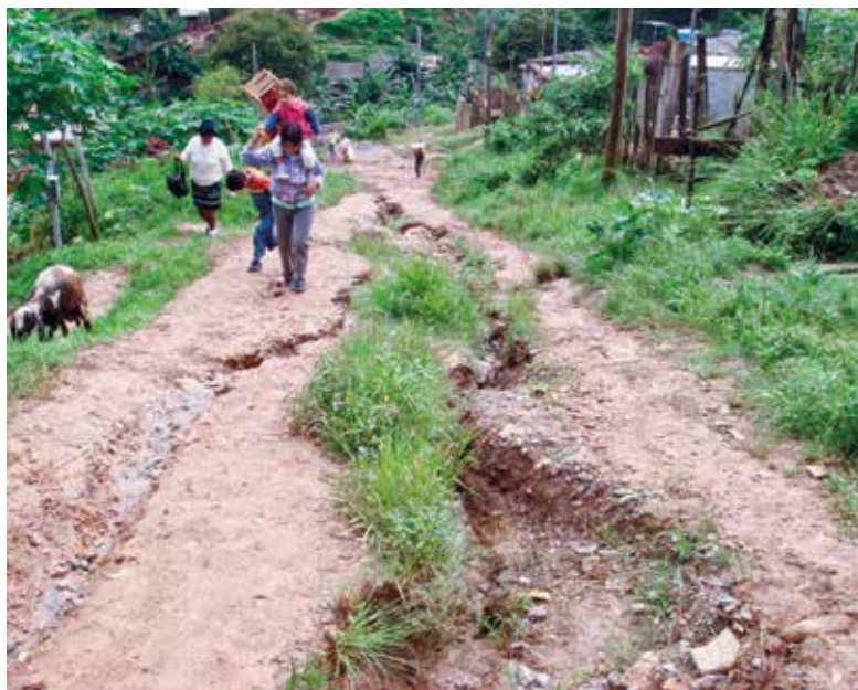
Figura 7: Vista dos sulcos e ravinas na rua dos Pinheiros Foto: Sandra Emi Sato, 15 dez. 2007
