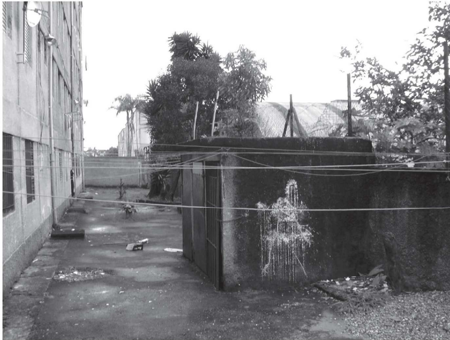
Imagem 10: Espaço residual de difícil acesso no Conjunto do Grajaú onde foi construída uma espécie de depósito. É um exemplo de área degradada que denigra a imagem do espaço livre
