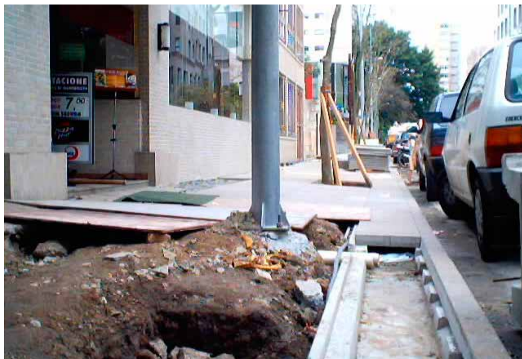
Figura 1d Conflitos aéreos e subterrâneos com a arborização. Rua Amauri, Jardim Europa, São Paulo (SP). em ruas da cidade de São Paulo.
