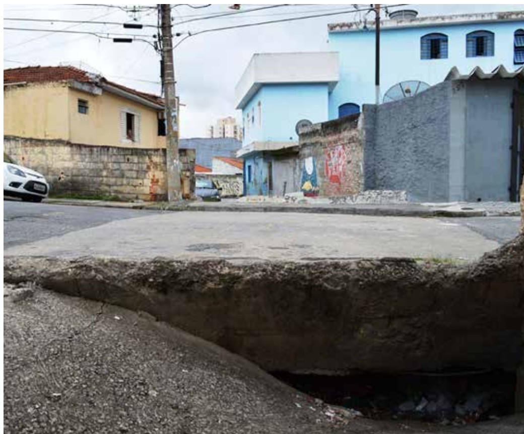
Figura 14 De ponte, a estrutura em concreto armado passou à condição de tampa. Foto: Arthur Simões Caetano Cabral – 2012
