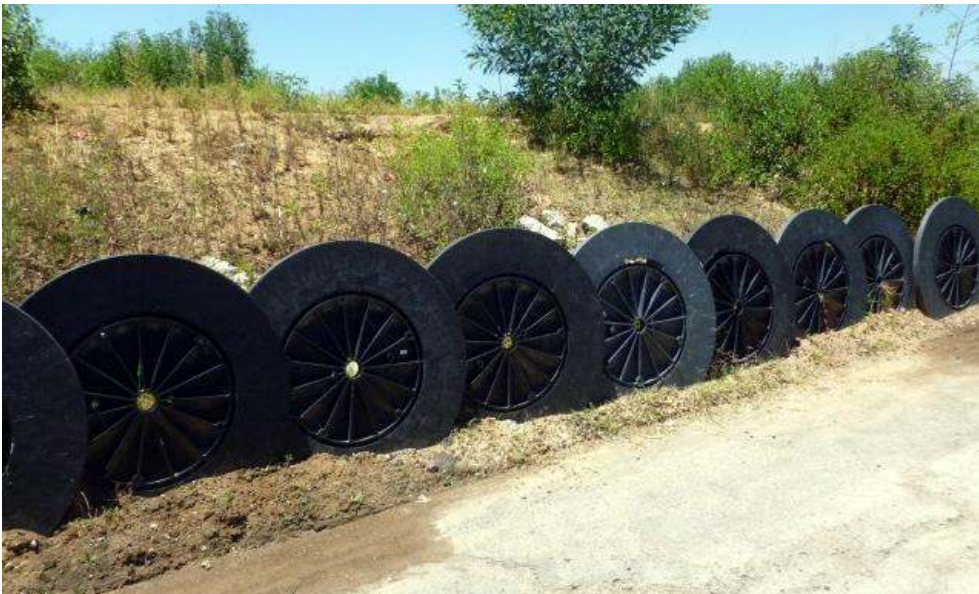
Imagen 7. Diques con discos de plástico en el perímetro del Río de los Remedios.
