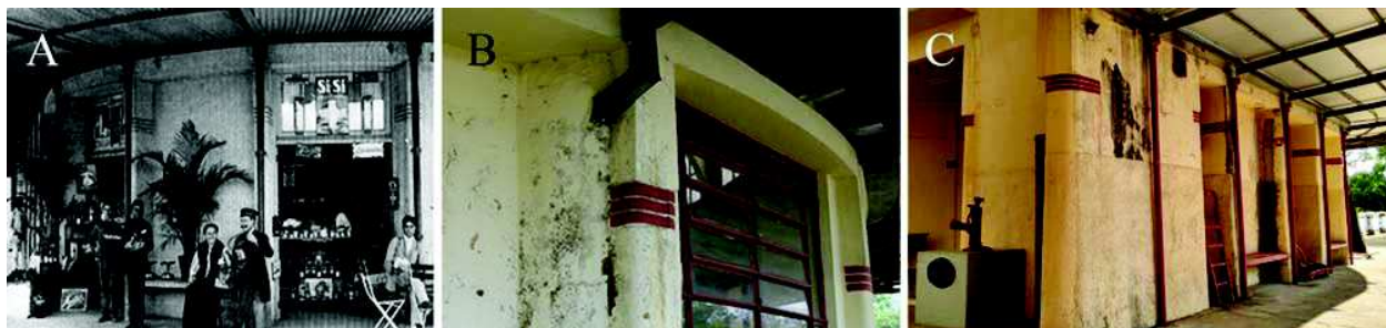
Figura 7: Condutores pluviais originais e a perda do elemento na fachada. Fonte: A (CONDEPHAAT, 1986), B (SECRETARIA DA CULTURA, 2014) e C (Acervo das autoras, 2016).
