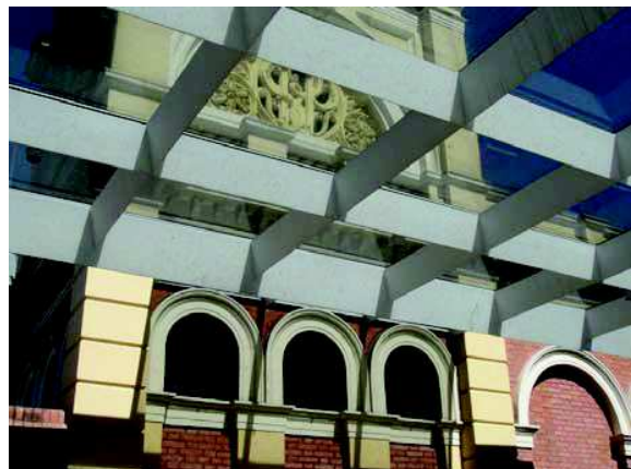
Figura 21: Nova cobertura metálica do Museu da Língua Portuguesa, na entrada da Estação da Luz. Fonte: Foto da autora.
