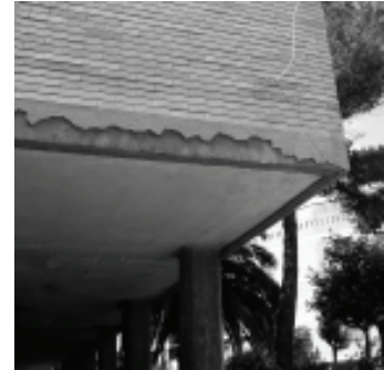
Figura 19: Decima. A degradação se manifestou, principalmente, onde a própria conformação do edifício continha elementos mais expostos à agressão dos agentes atmosféricos
