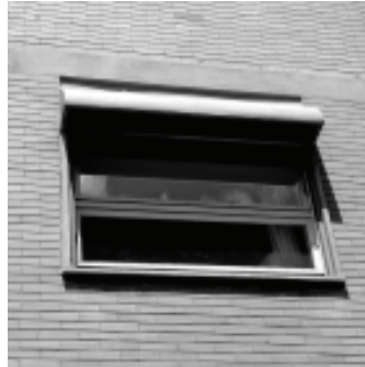
Figura 18: Decima. Pormenor de uma janela, em que se nota a grande atenção dada aos detalhes construtivos: os caixilhos foram frequentemente substituídos, mesmo, como é possível observar na foto, ainda presentes elementos originais em condições razoáveis de conservação
