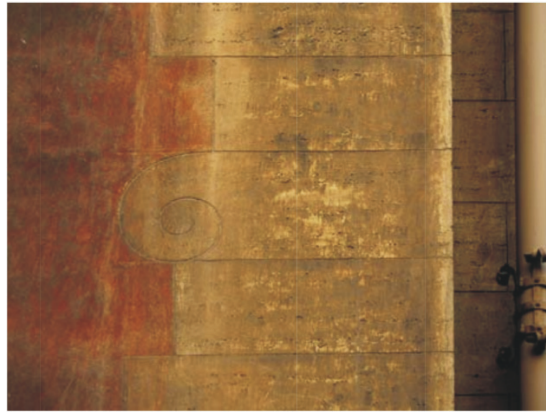
Figura 6: Prédio “dos embaixadores”. Pormenor da fachada da rua Dora, n. 1, em que estão bastante visíveis, na superfície, as marcas do tempo, tornando reconhecíveis as pinceladas da pintura e o trabalho de acabamento das superfícies que imitavam os elementos de travertino; na superfície das almofadas nota-se o trabalho imitando o acabamento em cinzeladura Fonte: Vide Figura 1
