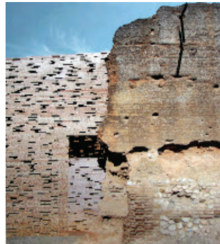
Figura 8: Detalle de la zona de contacto entre la parte reconstruida (izda) y la original en tapial (dcha) de la muralla nazarí de Granada Foto: Autora
