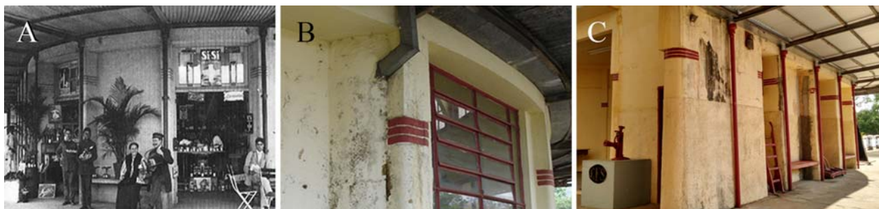
Figura 7: Condutores pluviais originais e a perda do elemento na fachada. Fonte: A (CONDEPHAAT, 1986), B (SECRETARIA DA CULTURA, 2014) e C (Acervo das autoras, 2016).
