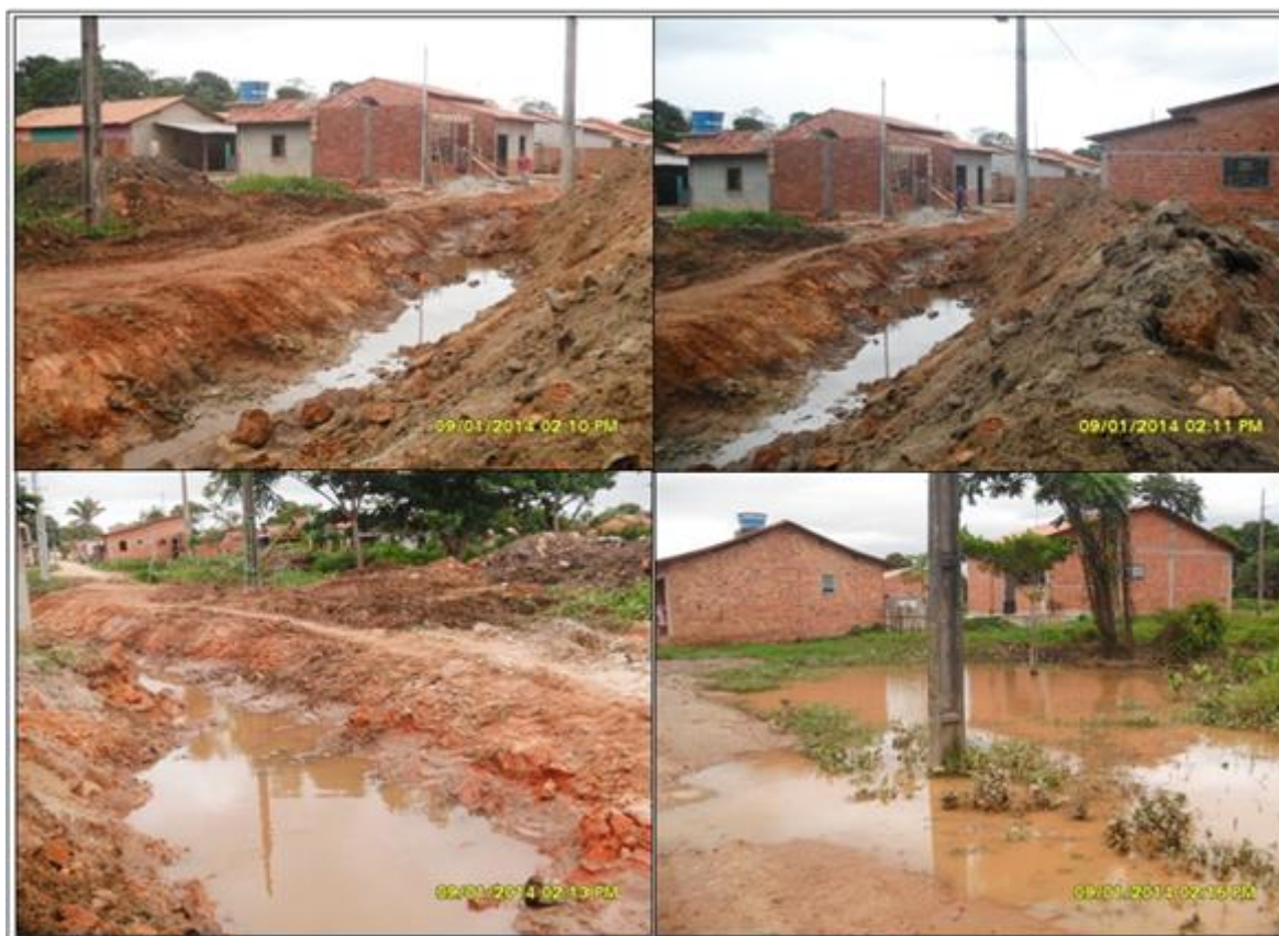
Figura 6: Abertura de canal com auxílio de retroescavadeira para escoamento das águas devido aos alagamentos na Travessa Santana, Bairro Padre Luiz. Fonte: registro de campo, COSTA, T.O; 2014.
