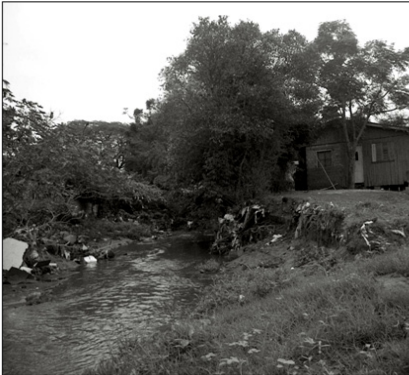
Figura 6 Seção do arroio Domeles localizada entre obras de intervenções estruturais hidráulicas, com margem côncava em intenso processo de solapamento.
