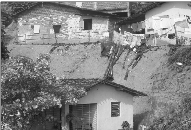
Figura 6 Corte inadequado da vertente.
