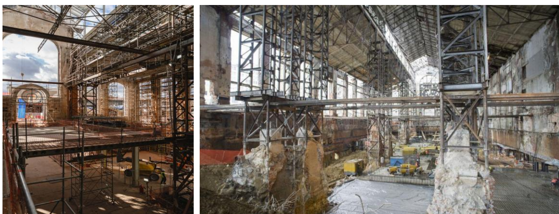
Figuras 8a e 8b: Imagens internas durante a obra. Fonte: GES-2 RPBW.
