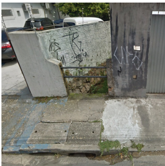
Figura 35 – Veio do córrego anônimo que deságua no córrego da Água Fria visto da R. Larival Géa Sanches. Fonte: Google Street View, 2016.
