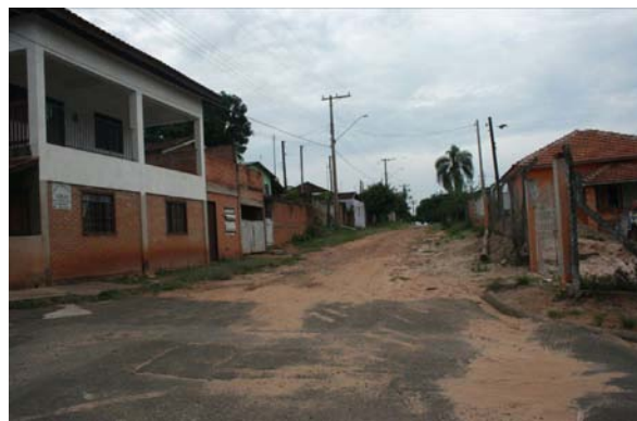
Figura 21: Logradouros sem drenagem. Foto: PATRÍCIA LIMA 2011
