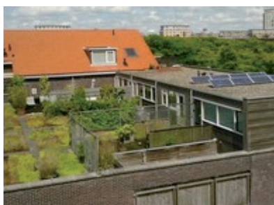
Telhado Verde Intensivo, Sistema de Energia Solar, Amsterdam 2012
