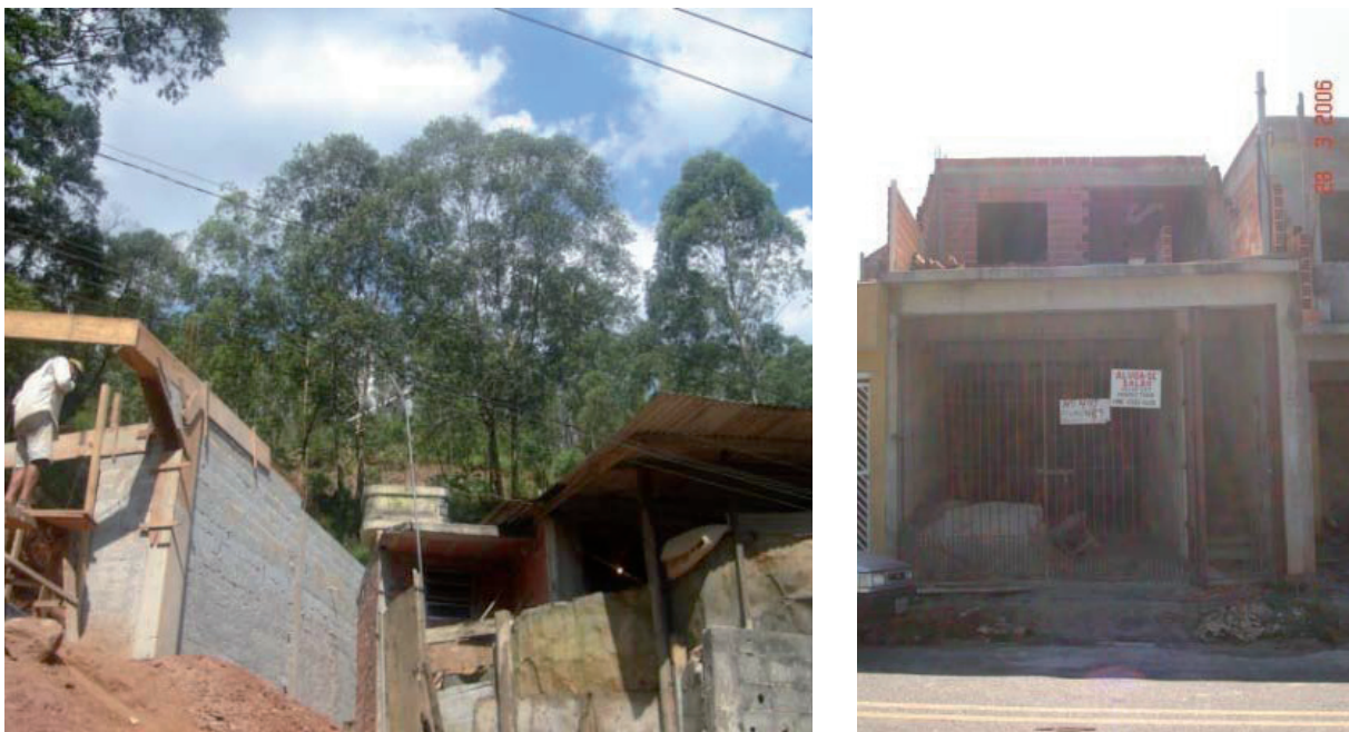
Figura 14 – Autoconstrução, aluguel de casas. Fonte: PMSBC - Fiscalização - Secretaria De Gestão Ambiental.
