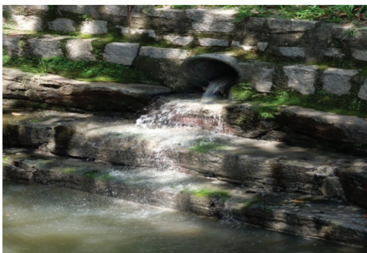
Figura 7 – Lançamento de esgoto doméstico no córrego Cachoeirinha. Fonte: Próprio Autor.
